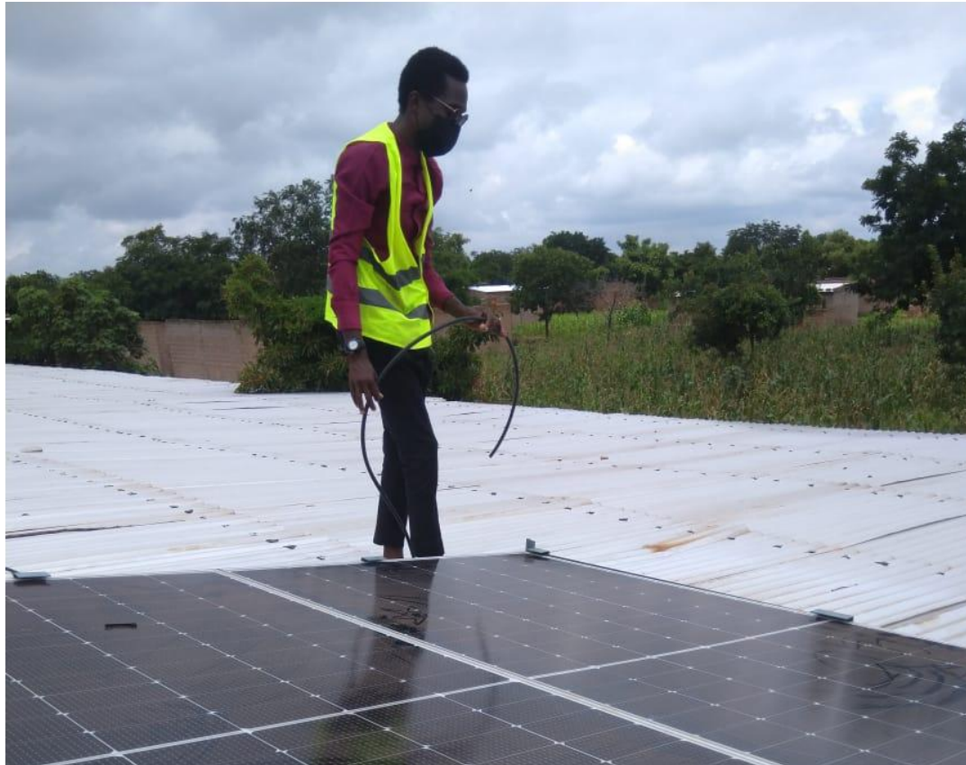
Eine Installation von Solafrique
