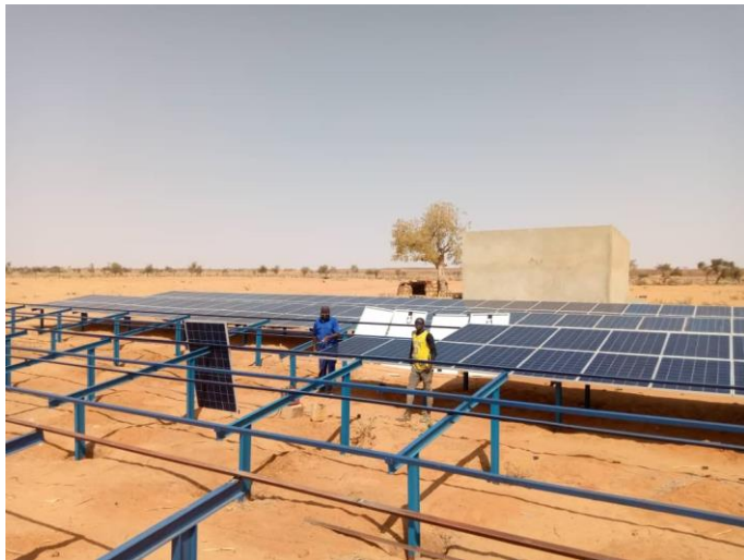
Eine neue Solaranlage von Solafrique
