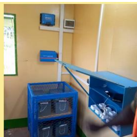
Station de charge de téléphone portable dans la cuisine du kiosque solaire
