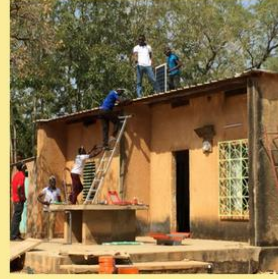
Installation solaire au centre catholique de Kouentou, réalisée par Solafrique (2016)
